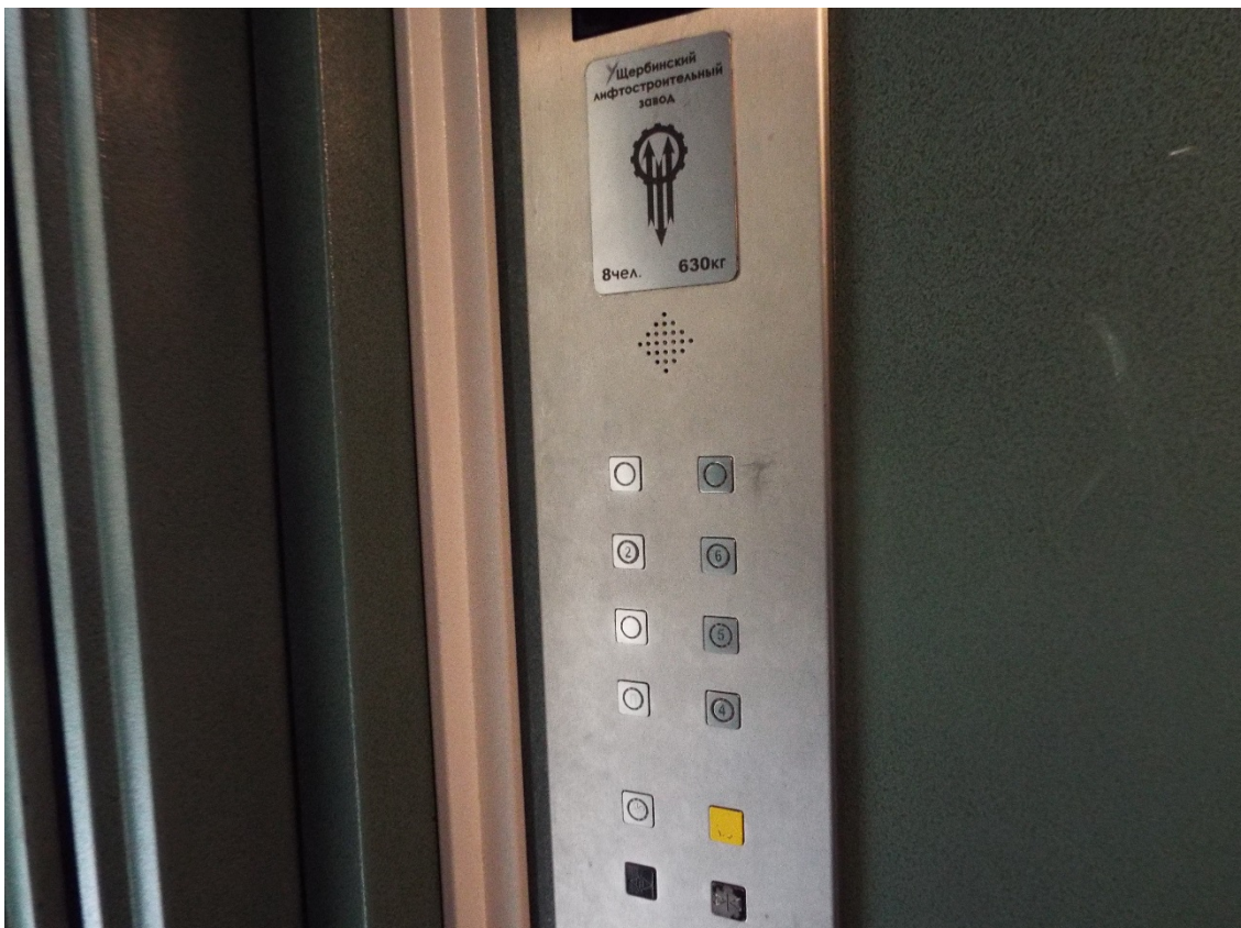
Фото Панель управления лифта
